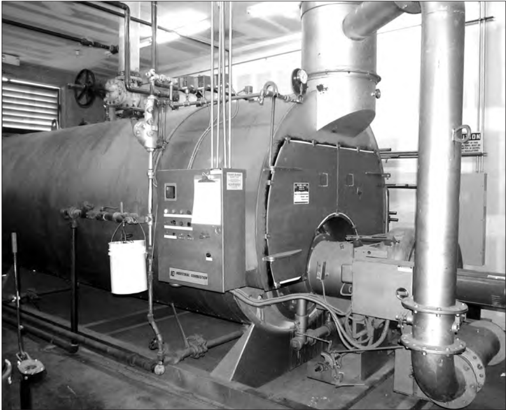
Figura 5 - La caldaia di Stone Brewing Co a Escondido, in California.
