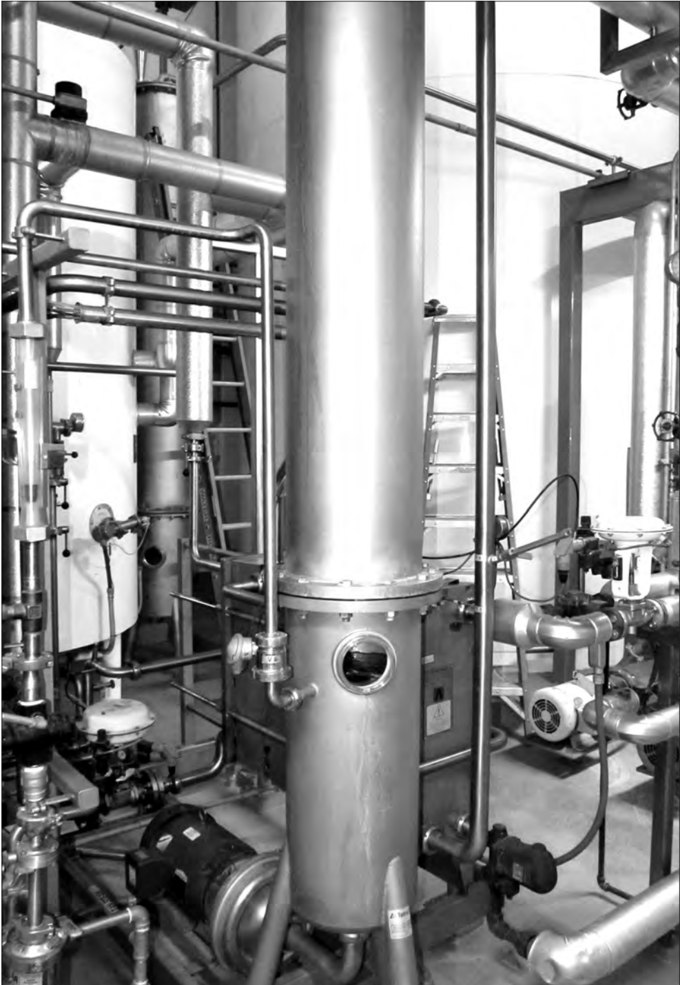
Figura 6 – Uno sguardo alla stanza di trattamento dell'acqua di Sierra Nevada Brewing Co., che mostra la metà inferiore della colonna di deaerazione.
